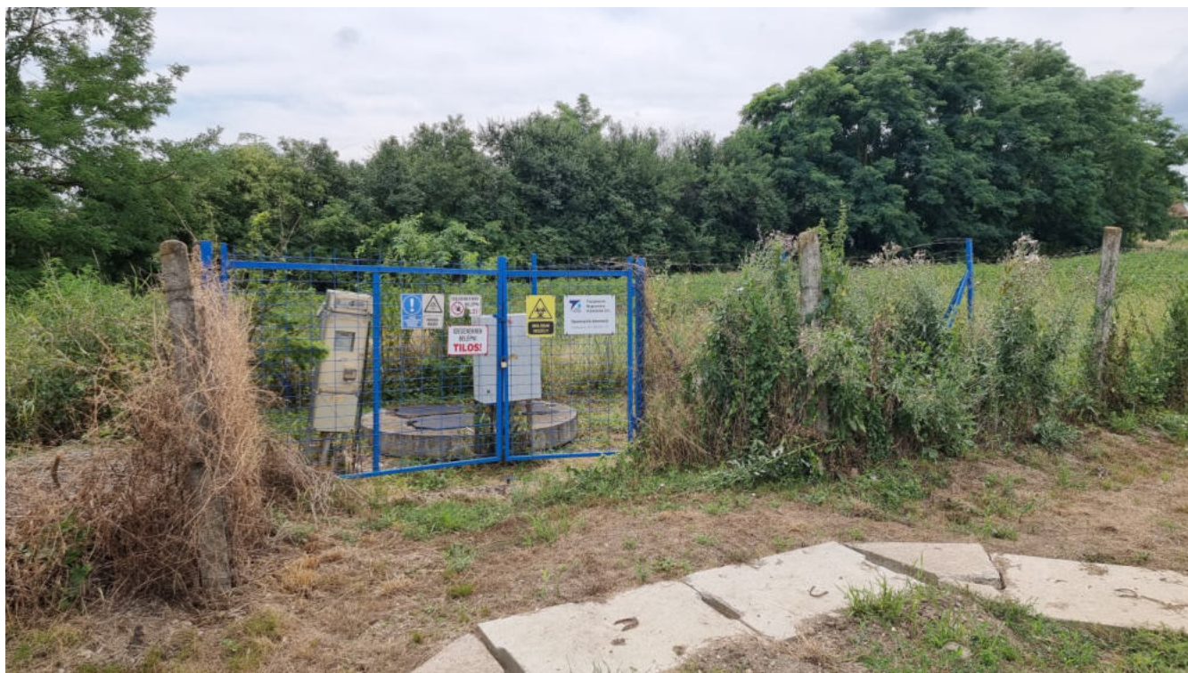
Szennyvízátemelő. Forrás: Saját fotó
